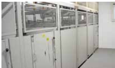
Hochspannungsfelder Messstation Kindergarten, Freienwil
