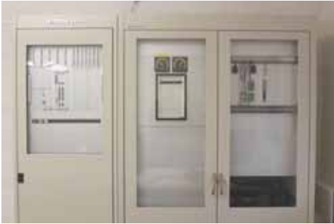
Fernwirkanlage und Steuerung Netzkommandoanlage im Werkhof
