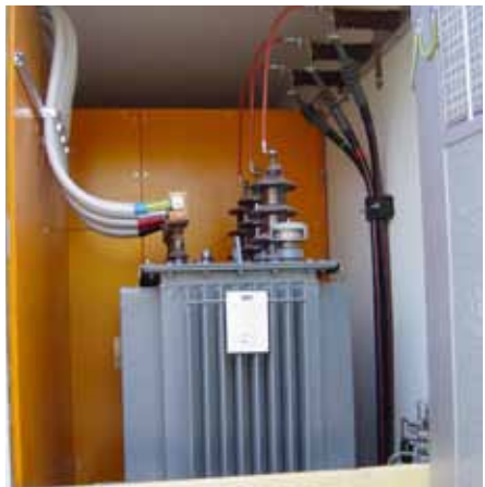
Rechts: Transformator in der Transformatorenstation lfang, Ehrendingen
