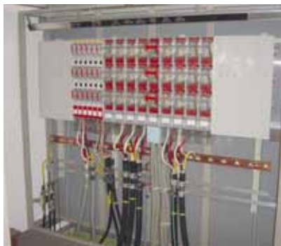
Niederspannungsverteilung Messstation Kindergarten, Freienwil
