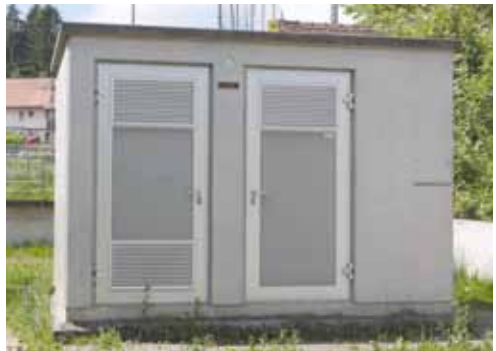
Transformatorenstation Dorf, Freienwil
