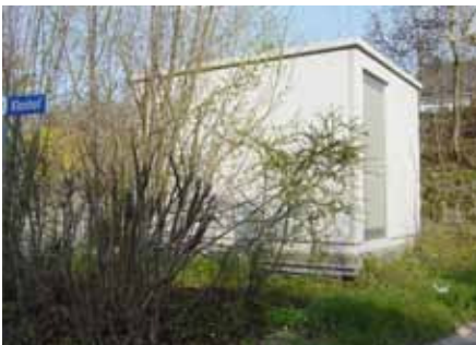
Oben: Transformatorenstation lfang, Ehrendingen
