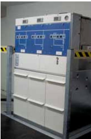
Hochspannungszellen in der Transformatorenstation Mühleweg, Ehrendingen
